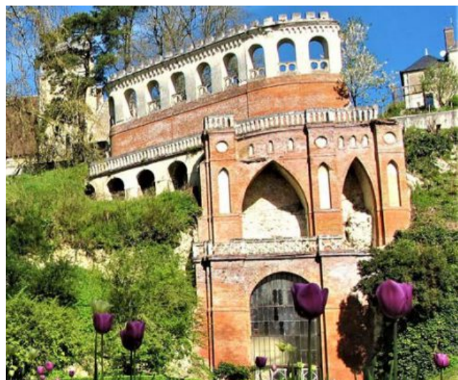
Il faudra 900 000 € pour consolider ce qui reste de la galerie Caroline. Château de Poncé
